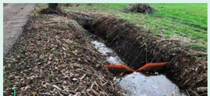
Figuur 17: Eenvoudige en goedkope stuwen, bestaande uit een stalen rijplaten waarin men een V-vormige opening aanbrengt om piekdebieten af te vlakken.
